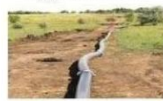
Трубы с БРС
